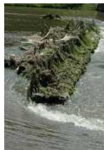
Un tas de débris et d'herbes sur le barrage. Au premier plan, ce qui a été emporté.
