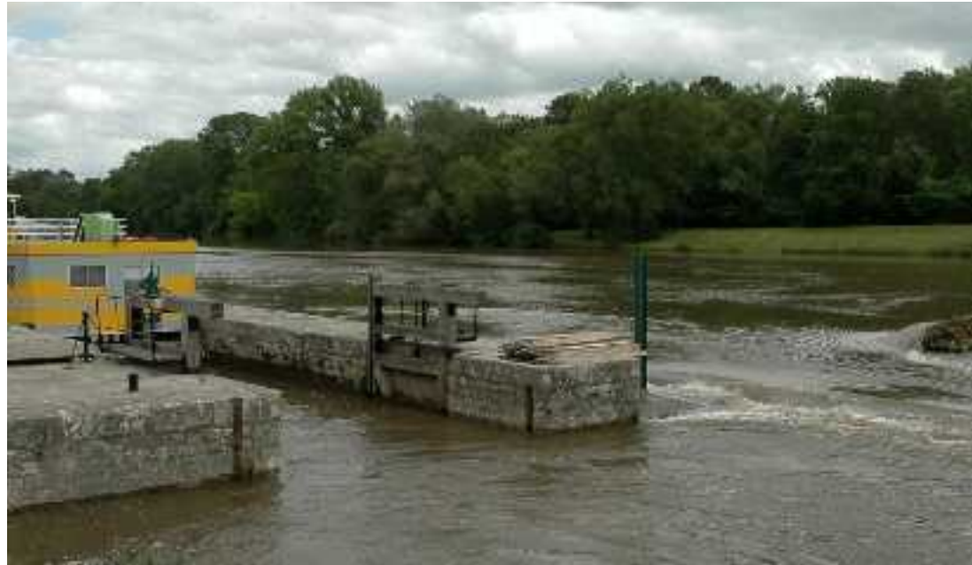
Le premier tiers du barrage, situé après l'écluse (à droite sur la photo) a été emporté par les eaux du Cher.
